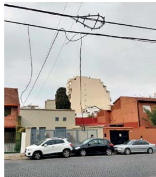
La telaraña de cables amenaza a los peatones que circulan por Naón, casi esquina Juramento.
